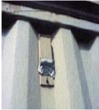
Feritoia di ventilazione otturata
